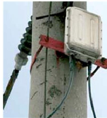
Муфта в металлическом корпусе с креплением, не предусматривающим размещение технологического запаса кабеля на опоре
